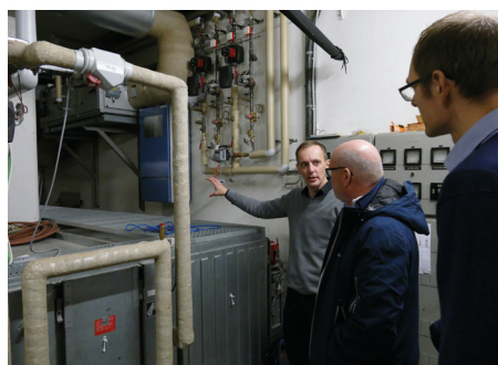
Thomas Kjems Lyngvad ved et af kommunens anlæg sammen med Henrik Madsen og Torben Dam og fra HM-ventilation, som var entreprenør på projektet.
